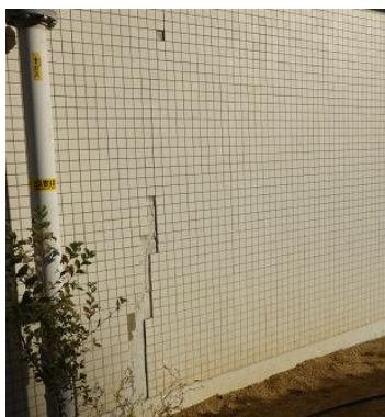
写真3 タイルの剥離
