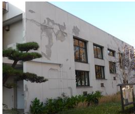
写真4 セメントモルタルの剥離
